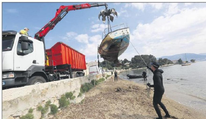
L'entreprise seynoise Reborhn (Camp-Laurent) surfe sur ce marché de la déconstruction de bateaux de plaisance, une filière encore peu développée.
